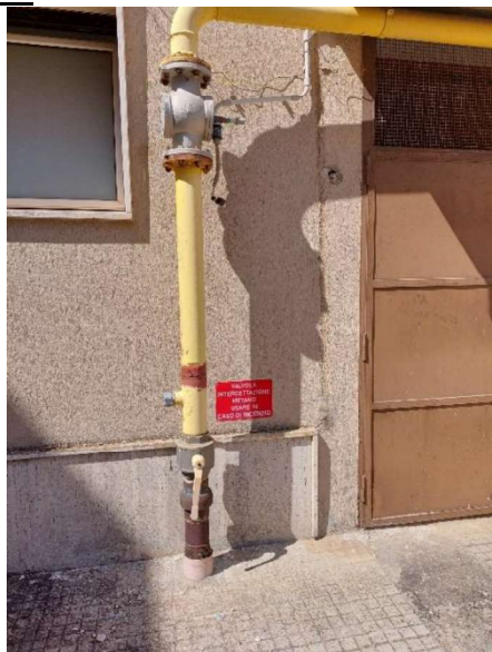
Figura 1: Intercettazione valvola gas metano atrio interno prossimità centrale termica
