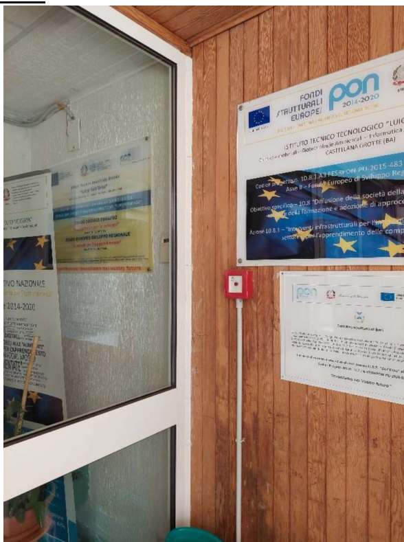
Figura 2: Interruttore elettrico vetro a rottura all'ingresso della sede
