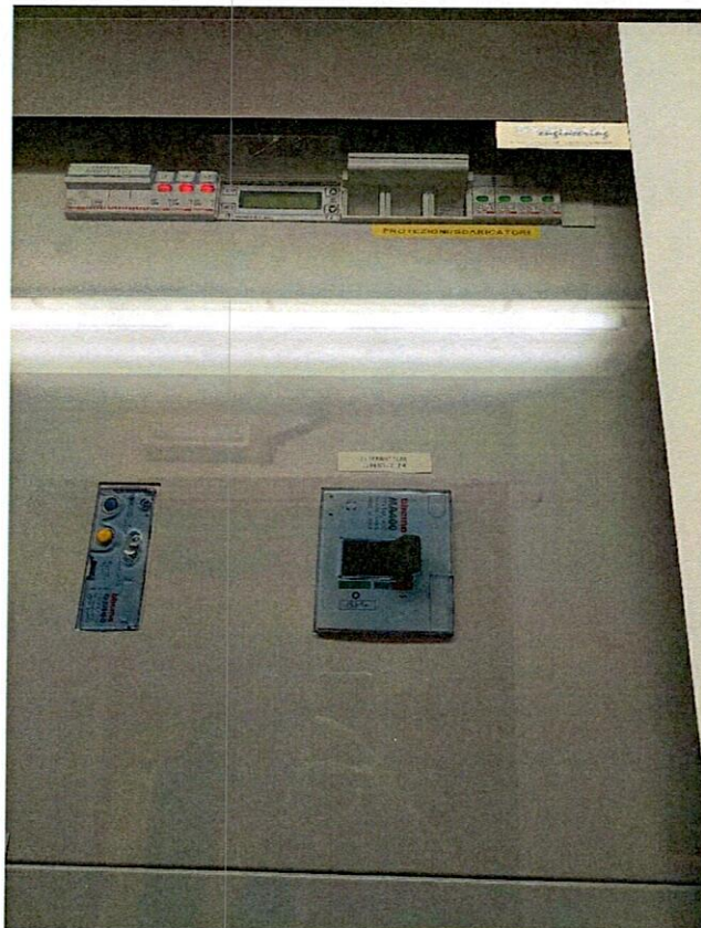
Figura 3: In alternativa - Interruttore elettrico generale nel quadro piano terra
